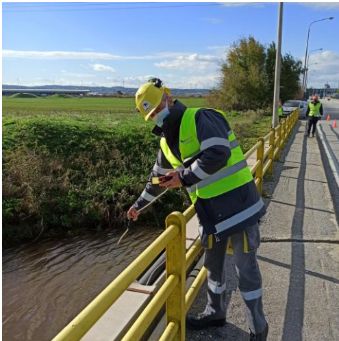
Έλεγχος διαρροής αερίου Δικτύου Χαμηλής Πίεσης
