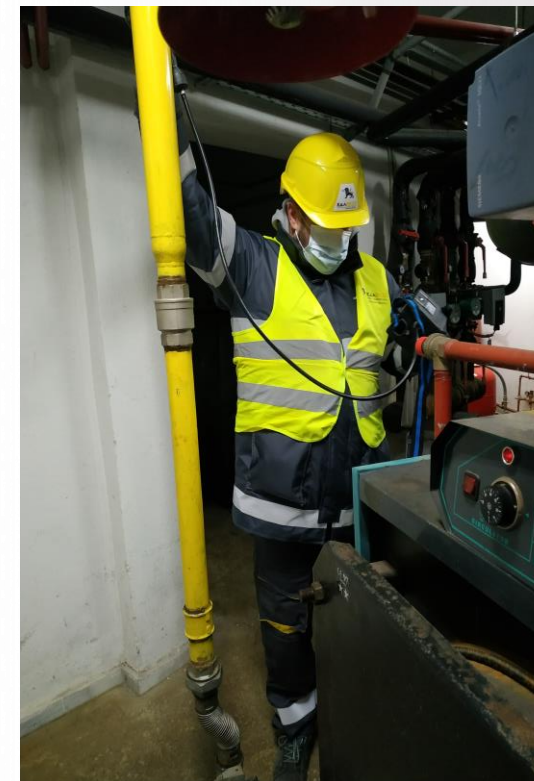
Έλεγχος διαρροής λεβητοστασίου σε Δημοτικό Κτίριο
