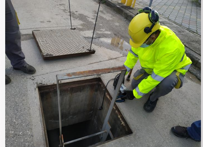
Κλείσιμο Βάνας Δικτύου Μέσης Πίεσης
