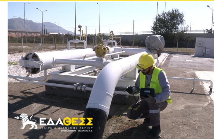
Έλεγχος Διαρροών στο σημείο εισόδου δικτύου διανομής Βόρεια Λάρισα
