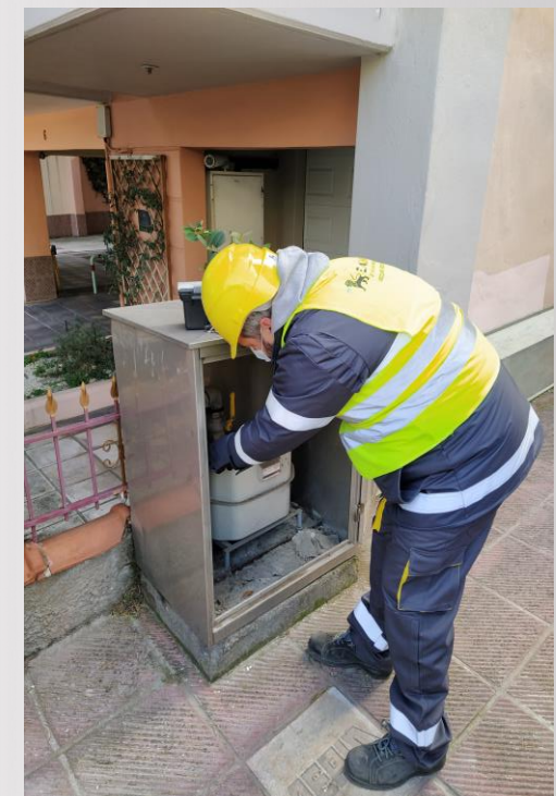
Διακοπή Τροφοδοσίας σε Δημοτικό Κτίριο
